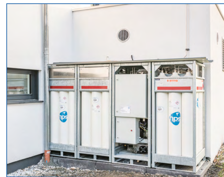
Außerhalb des Gebäudes wird der Wasserstoff in Stahlflaschen gelagert. Fotos: HPS Home Power Solutions GmbH
