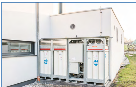
Die Energiezentrale steht im Keller oder im Hauswirtschaftsraum. Auf 1,5 m 2 findet alles Platz, was man für eine ganzjährige Solarstromversorgung braucht.
