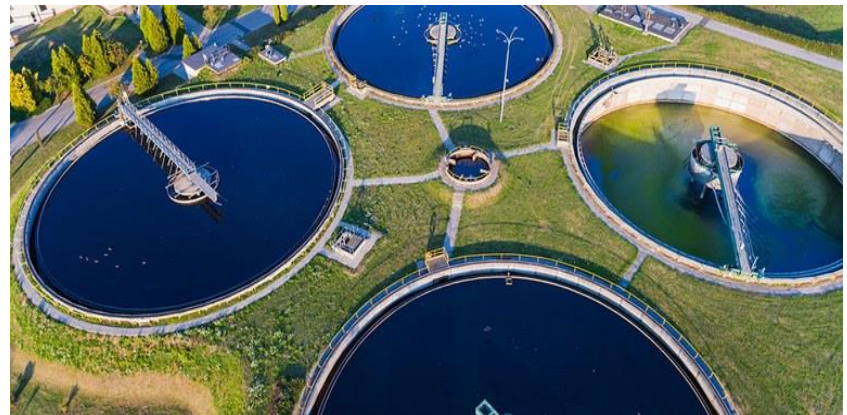
Belebungsbecken in Kläranlagen, © Fotolia.com - Daniel Jędzura
